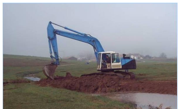
Abb. 2.2.11: Der alte Bachlauf wird durch Dammschüttung gestaut. So wird das Wasser in den neuen Bachlauf (links am Bildrand) geleitet. (Foto Elser)
