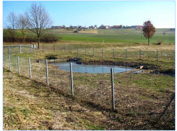
Abb. 2.4.16: Das Regenklärbecken für die K 3219 musste mit einem etwa 1 Meter hohen Damm vor dem Rothochwasser geschützt werden, dessen Böschung in der linken unteren Bildecke zu erahnen ist.
