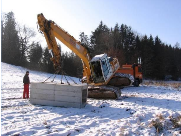
Abb. 2.6.12: Einer von zwei maßangefertigten Hohlkästen wird transportiert. Das Bauteil aus Stahlbeton ist 3 Meter lang und wiegt ca. 6 Tonnen!
