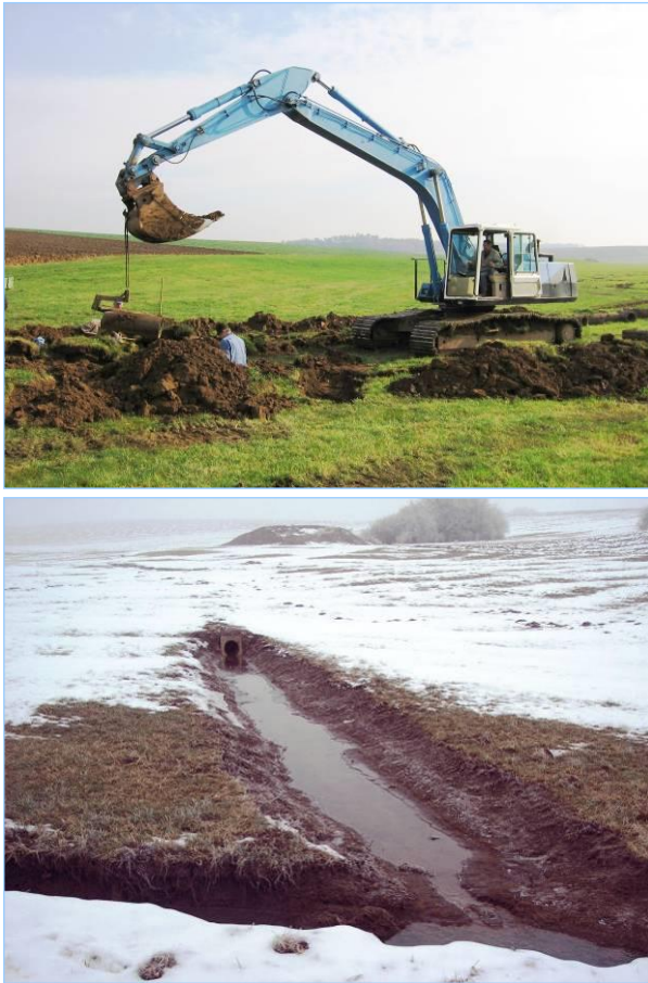
Abb. 3.1.7: Anhebung einer Betonrohr-Drainage zum Zwecke der Einmündung in den renaturierten Bachlauf (unten: fertiger Auslauf). (Schlierbach)
