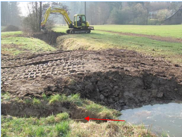
Abb. 1.2.7: Dammschüttung mit Ausleitung aus dem alten Bach (Pfeil) in Fließrichtung vor dem Damm. (Glasbach Rosenberg)
