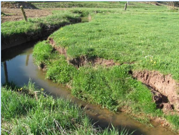
Abb. 2.6.20: Einer von zahlreichen Uferabbrüchen.
