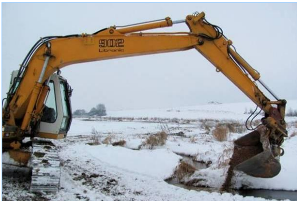
Abb. 2.8.9: Kieseinbringung: Mit unglaublichem Geschick folgt der Baggerlöffel zügig dem mäandrierenden Bach. So wurde an Schlierbach-Sechta in Tannhausen (siehe Kap. 2.2) Kies eingebracht. Am Glasbach ist dies für Sommer 2011 geplant.
