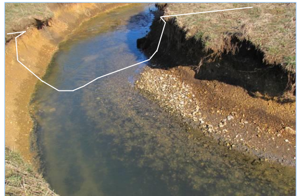
Abb. 2.7.42: Durch Querströmungsinduktion im gekrümmten Lauf hat sich die Fließrinne zum Außenhang (Prallhang) verlagert und durch Sedimentation ist ein Gleithang entstanden. Kaum zu glauben, dass vor einem halben Jahr noch ein Rechteckprofil mit senkrechten Uferböschungen vorlag.
