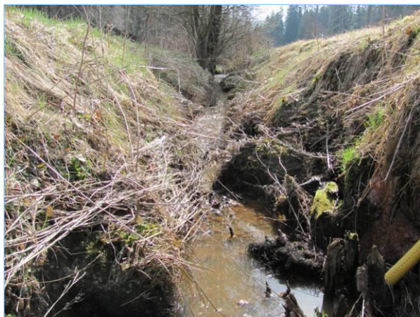
Abb. 2.8.2: Ausbautzustand des oberen Bachabschnitts. Durch die Überdimensionierung des Querprofils erfolgt bei Hochwasser Tiefenerosion.
